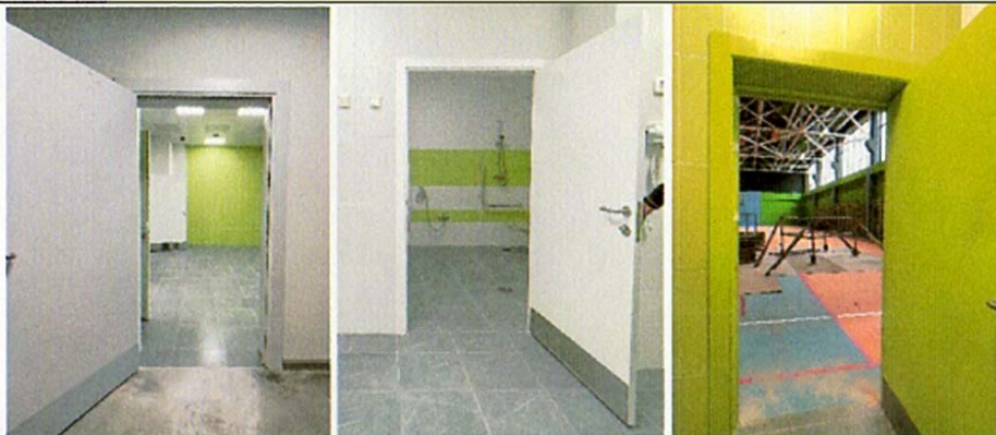
Фото 13. В спортивном зале, у дверей раздевальных помещений, санузлов, душевых, отсутствуют пиктограммы доступности для инвалидов
