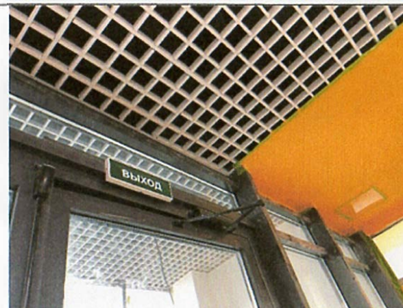
Фото 4. Двери с доводчиком, не обеспечивают задержку закрывания, продолжительностью не менее 5 секунд
