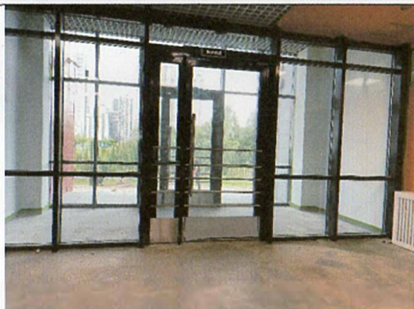
Фото 3 На стеклянном полотне входной двери, отсутствует контрастная маркировка
