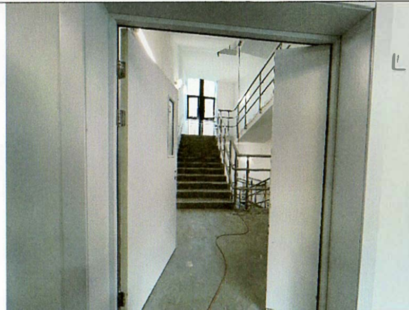
Фото 8. Двери с доводчиком, не обеспечивают задержку закрывания, продолжительностью не менее 5 секунд
