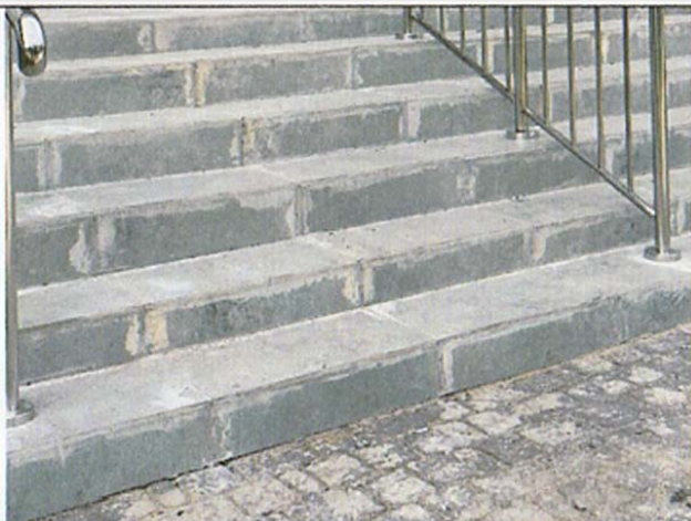
Фото 1. Наружный лестничный марш. Отсутствует тактильная контрастная наземная предупреждающая информация. На краевых ступенях лестницы отсутствует контрастная маркировка
