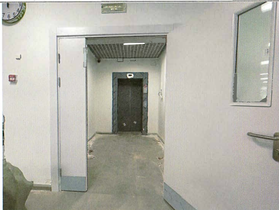
Фото 9. Отсутствует визуальная тактильная информация у входных дверей в помещения.
