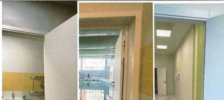
Фото 12. Двери с доводчиком, не обеспечивают задержку закрывания, продолжительностью не менее 5 сек.
