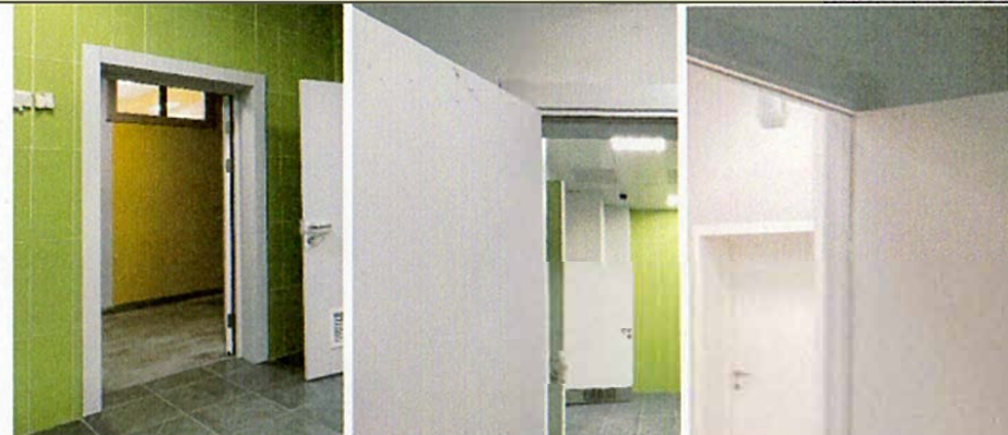
Фото 14. Двери с доводчиком, не обеспечивают задержку закрывания, продолжительностью не менее 5 сек.
