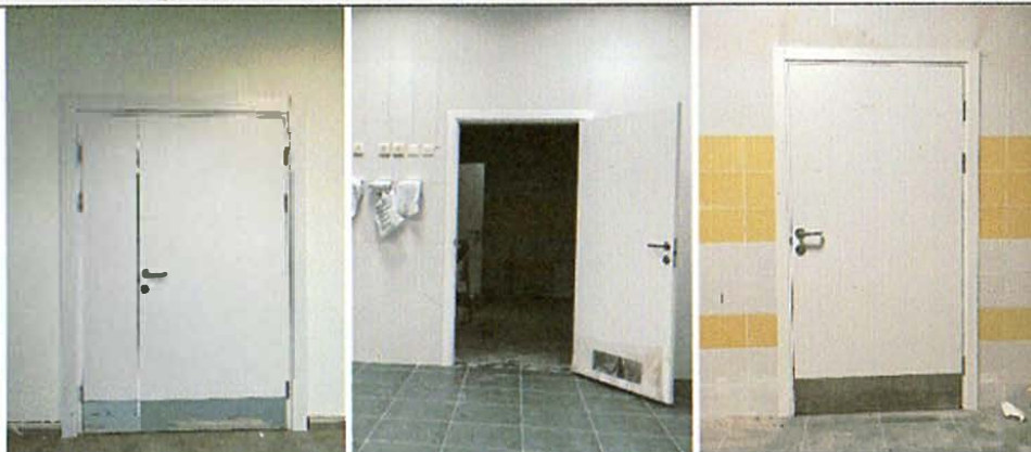
Фото 11. У дверей раздевальных помещений, санузлов, душевых, отсутствуют пиктограммы доступности помещений для инвалидов.
